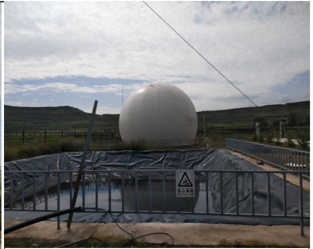
沼液池及储气柜
