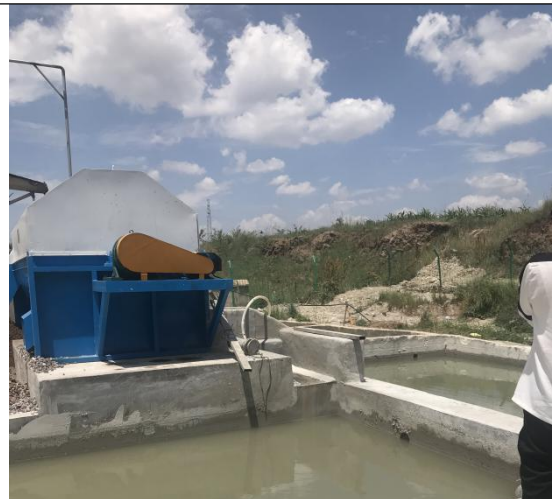
洗车废水沉淀池
